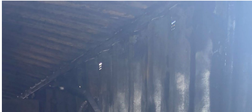
Bild 9 visar två av åtta ventilationsöppningar. Källa RSG
